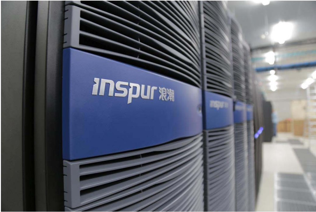
图 格力电器超算中心机房
